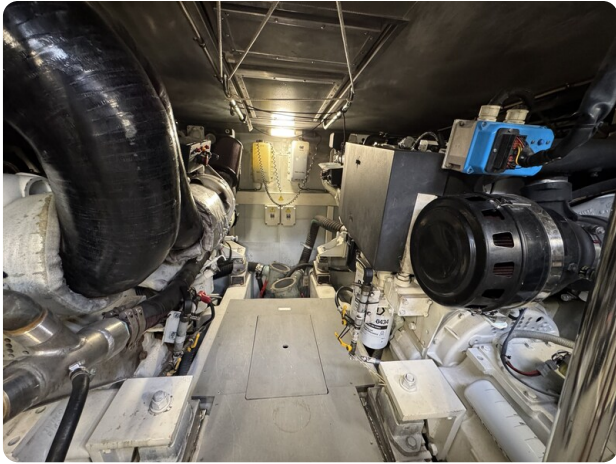
AZ 62E engine room
